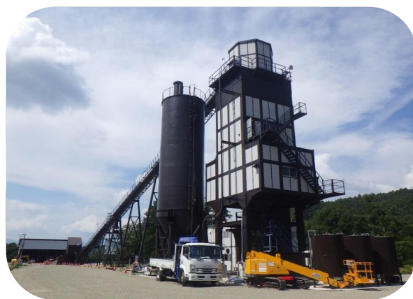
ダム用仮設備全景
